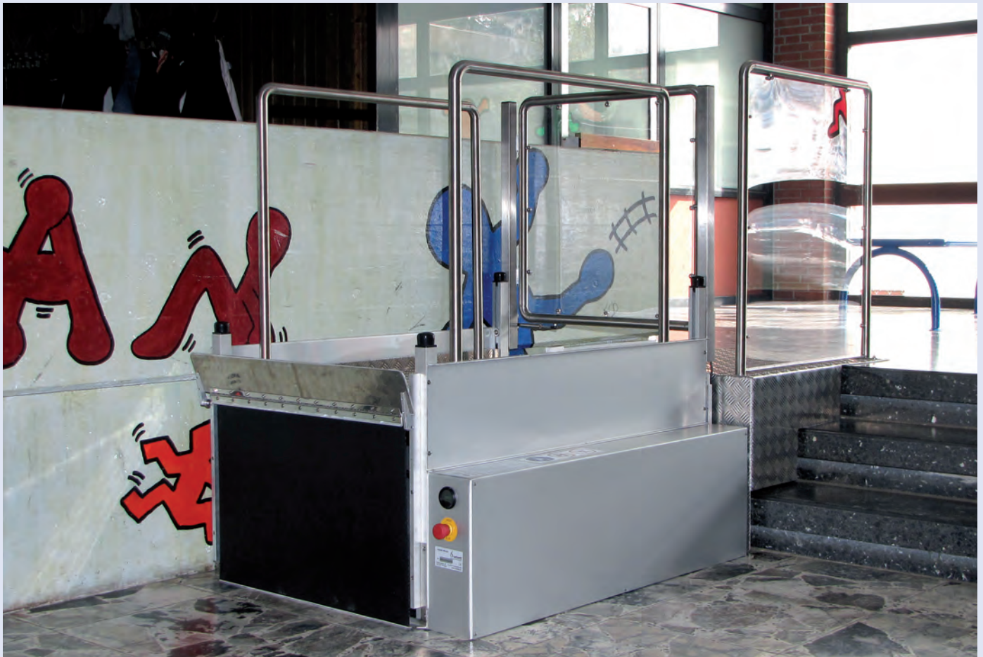
Bereits im Eingangsbereich der Schule müssen Stufen überwunden werden.
